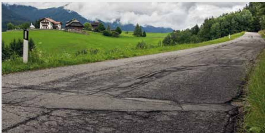
Mittlerweile wurden die ärgsten Schäden an der Sallastraße ausgebessert. Auf lange Sicht führt jedoch kein Weg an einer Generalsanierung der Straße vorbei.
