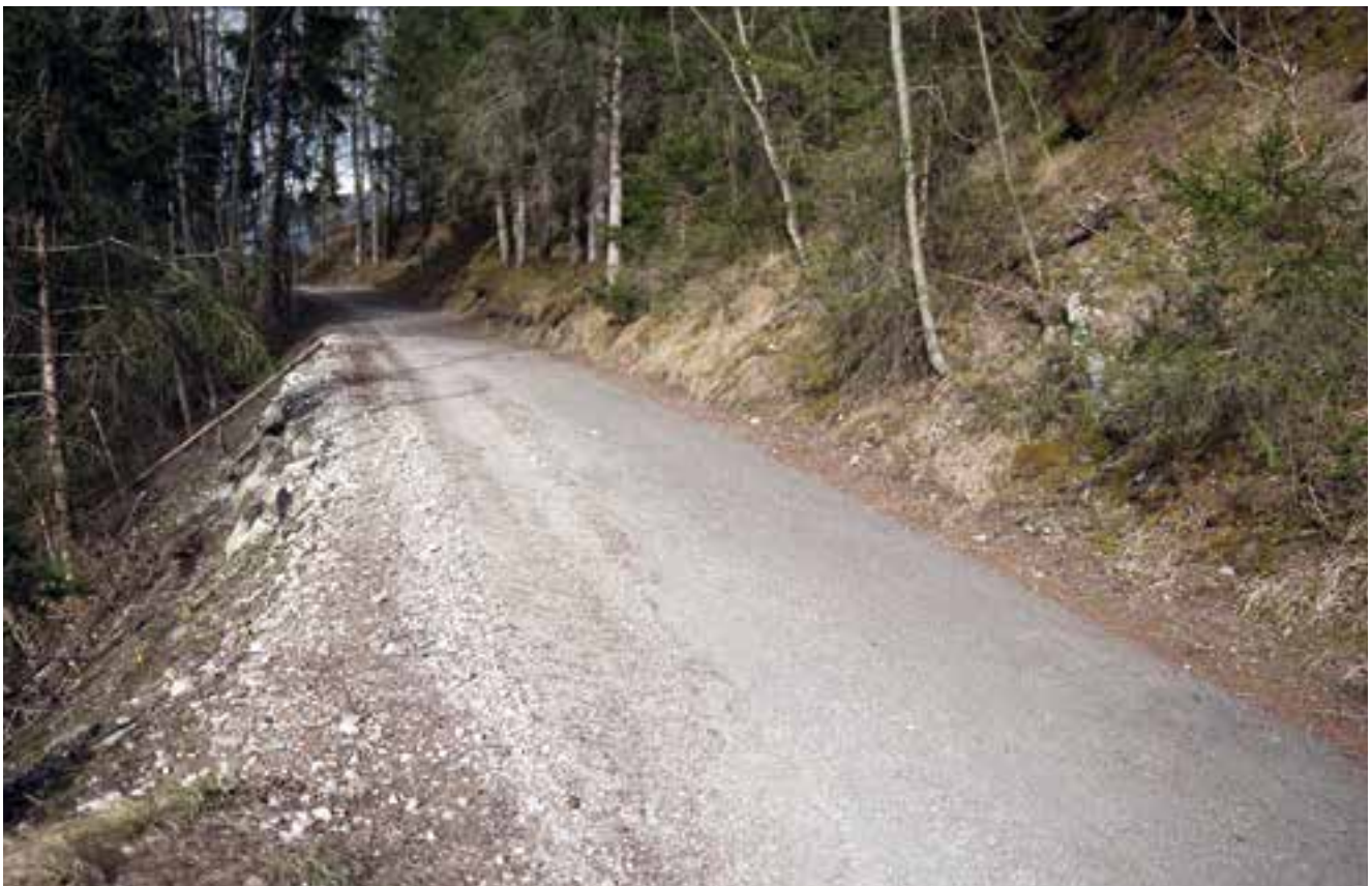
Die Straße über die „Wolfsgrube“ ist stark beschädigt und wird neu asphaltiert.
