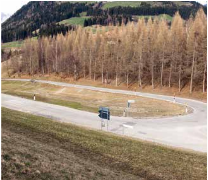
Im Bereich des „Lipper Tals“ wird bei starken Regenfällen immer wieder Material auf die Straße geschwemmt, weshalb hier eine Sanierung der Straße notwendig ist.
