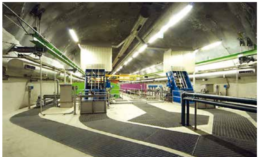
mechanische Vorreinigung, Rechen
