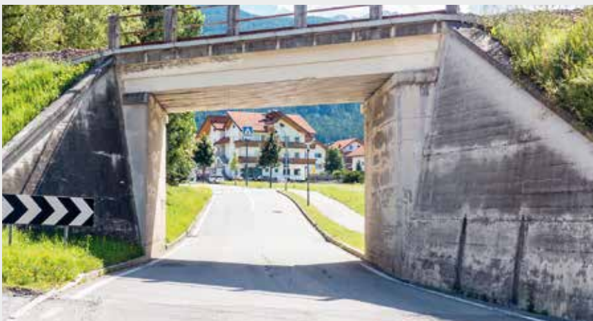
Das Tor nach Mitterolang: Die Bahnunterführung hat schon mal besser ausgesehen. Ein neuer Anstrich sei längst überfällig.
