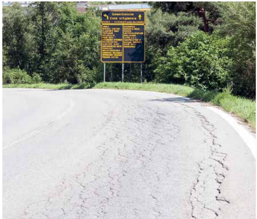
Die Zufahrtsstraße zur Industriezone ist durch den Schwerverkehr arg in Mitleidenschaft gezogen und muss saniert werden.
