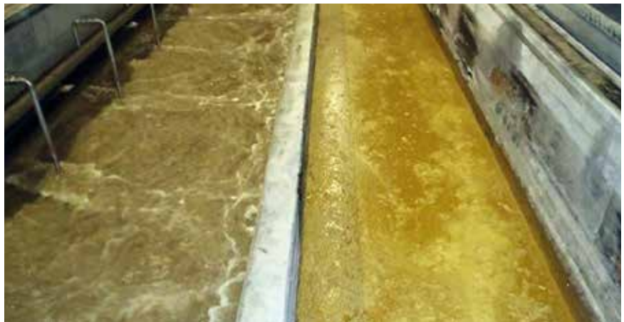
Sandfang mit Fettfang
