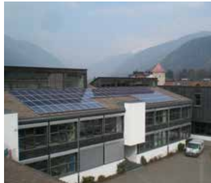
Die Fenster der Mittelschule Olang müssen dringend saniert werden.
