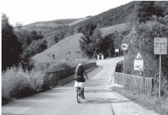
Die Gefahrenstelle für die Radfahrer wird entschärft, ein Neubau der ganzen Brücke kommt auf Grund der ablehnenden Haltung der Gemeinde Rasen Antholz derzeit nicht in Frage. (Foto: "sq"/rb)
