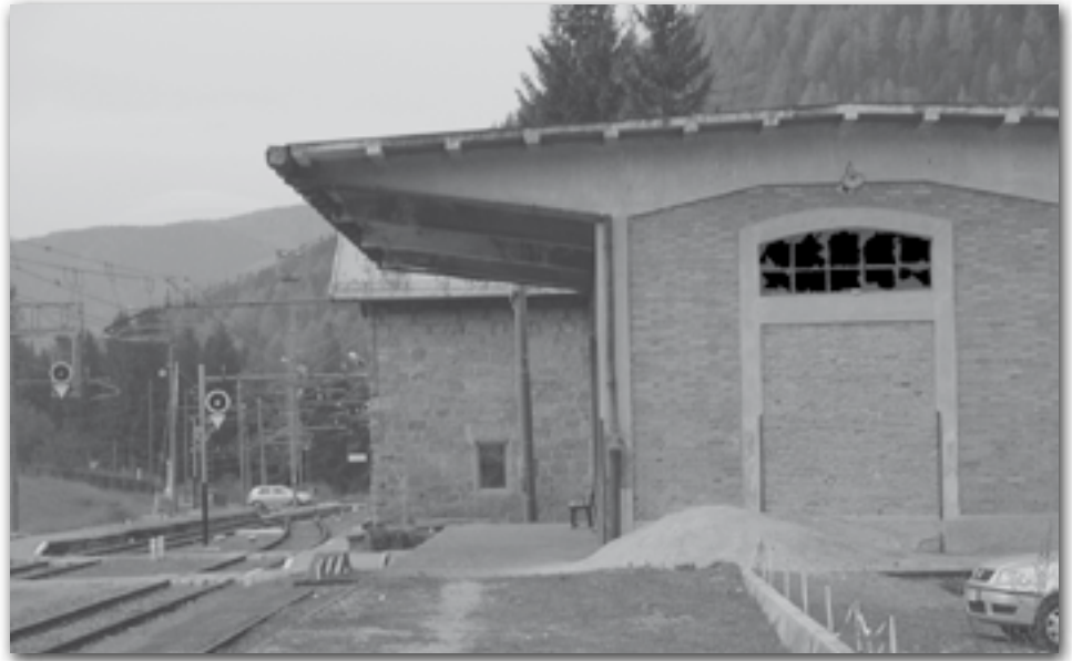
Der alte Bahnhof ist dringend sanierungsbedürftig, die Gebäude werden trotz des Neubaus saniert und hergerichtet, kündigte die Bürgermeisterin an. (Fotos: „SQ“/rb)
