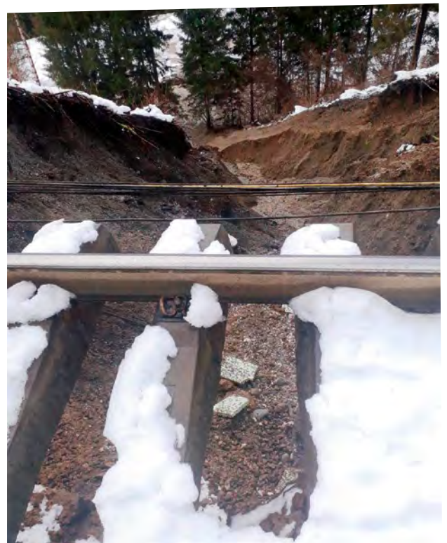
Große Murbrüche, Steinschläge, Baumstürze und Wasseransammlung sorgen an verschiedenen Stellen für problematische Zustände. Die unterbrochene Bahnlinie musste in der Folge aufwändig saniert werden.
